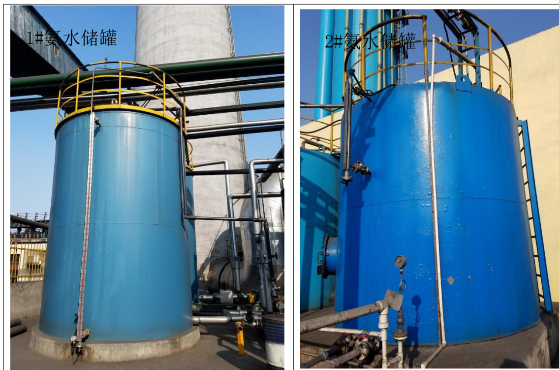
图 3-2 氨水储罐现场照片
